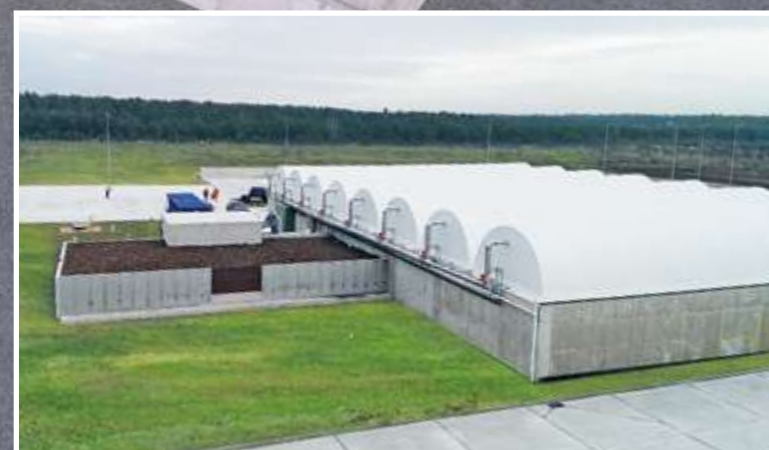
Sistema de tratamiento del airea residual
