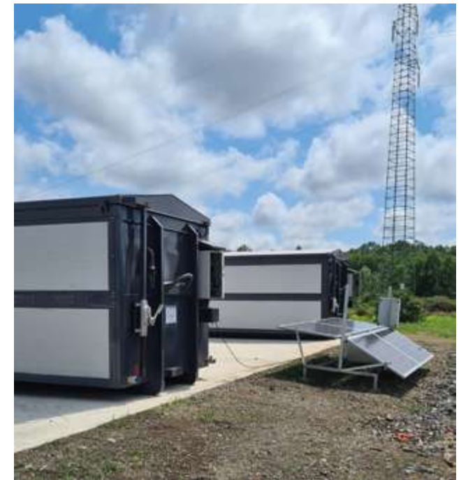
Contenedores CSC y sistema FV.
