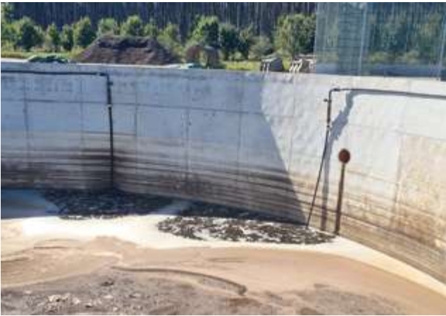
Aireación del lixiviado para mantenerlo aeróbico.
