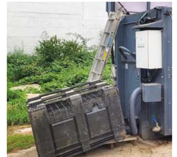
230-V-Belüftungsventilator über Schnellkupplung angeschlossen.
