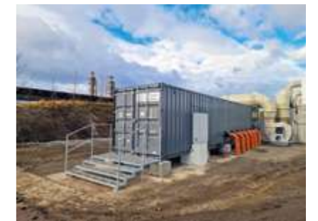
Steuerungscontainer zur Überwachung des Kompostierprozesses.
