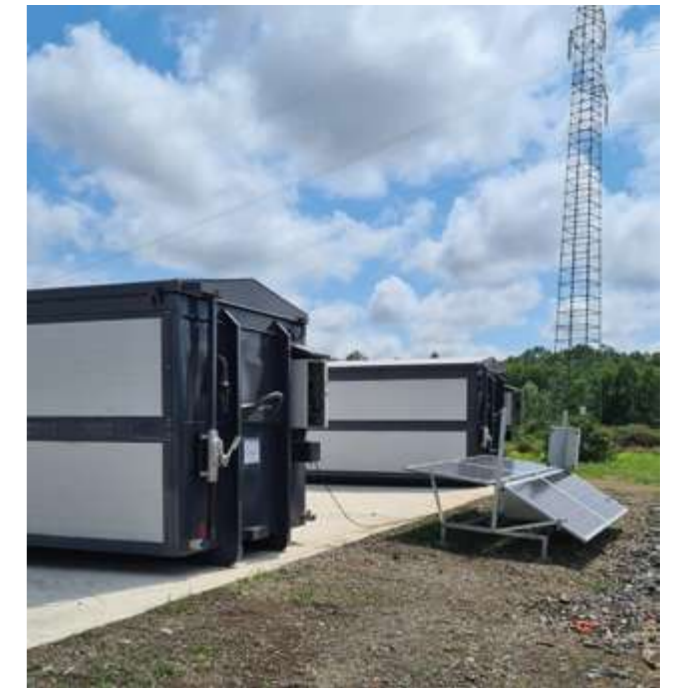
CSC-Container und PV-Anlage.
