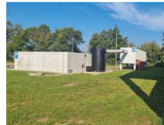
Biofilter mit Waschbox.
