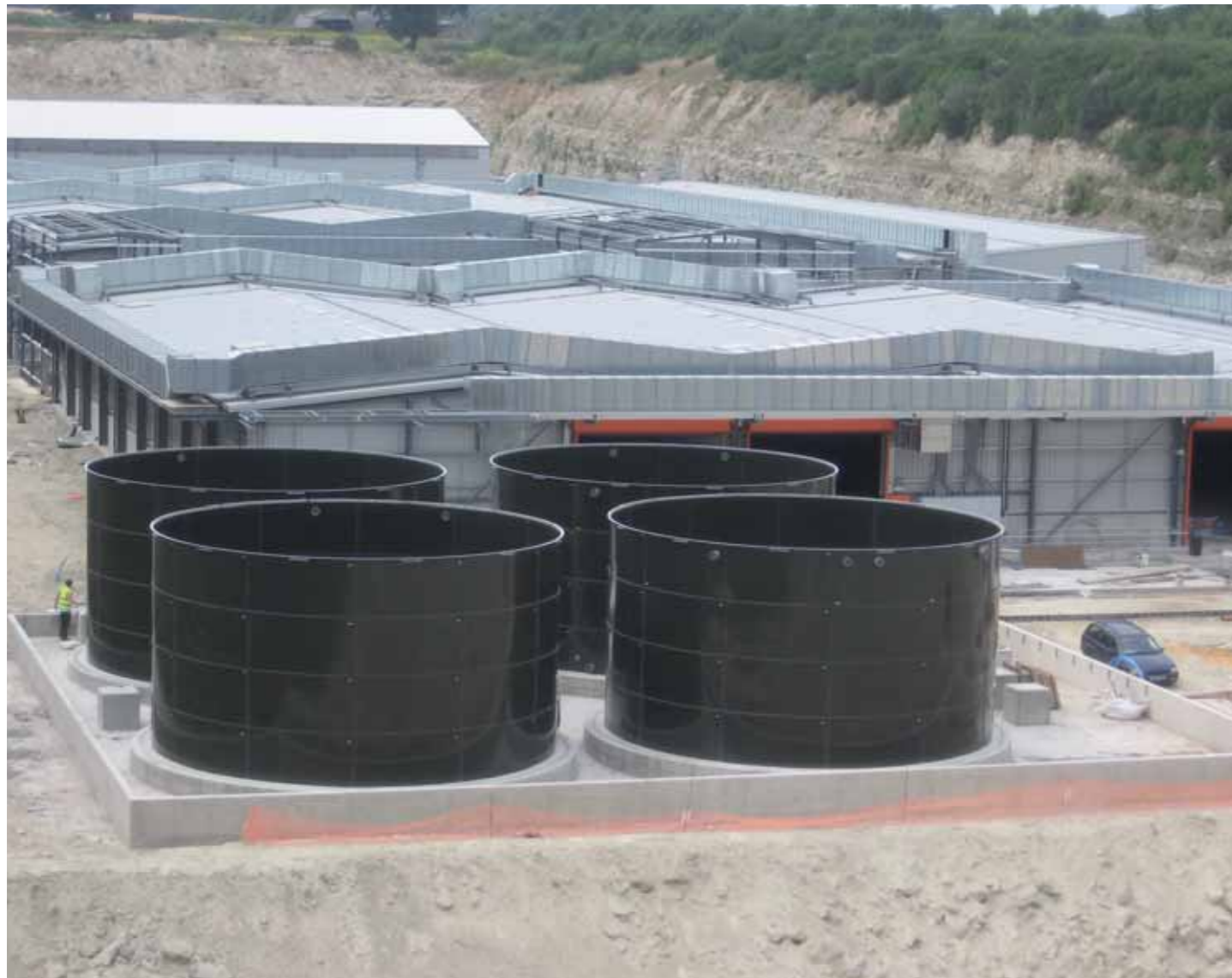
Auf ca. 10.000m 2 Rottehallen werden im Jahr 50.000t Bioabfall verarbeitet.
