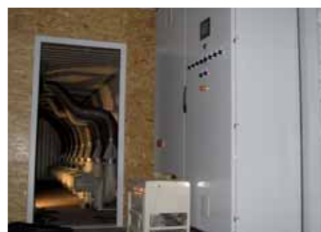
Der COMPOtainer ist die zentrale Lüfterstation und wurde von Compost Systems komplett montiert geliefert.
