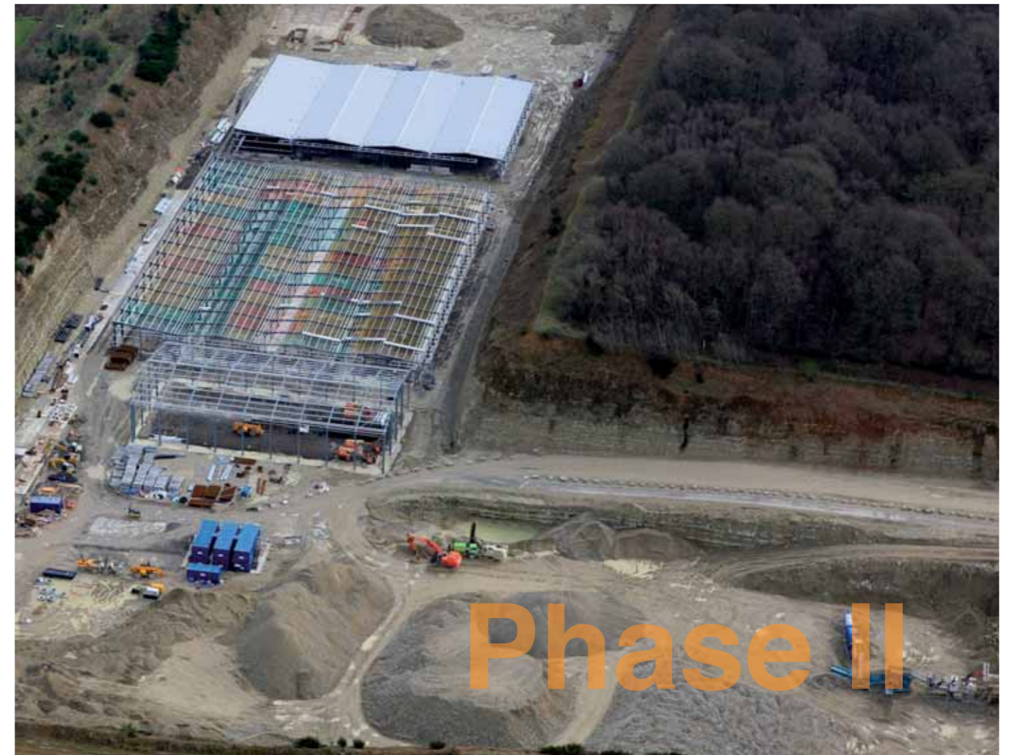
Im Winter 2007/ 2008 wurde mit den Bauarbeiten in Kent begonnen. Bereits im September 2008 konnte der Probebetrieb aufgenommen werden. Während an der ersten Ausbaustufe der Anlage noch kräftig gearbeitet wurde, liefen bereits die Vorbereitungen für die 2. Ausbaustufe (rechts unten im Bild). Mit einer Gesamtkapazität von 100.000t/Jahr soll der Standort Kent in Zukunft ausgelastet werden.
